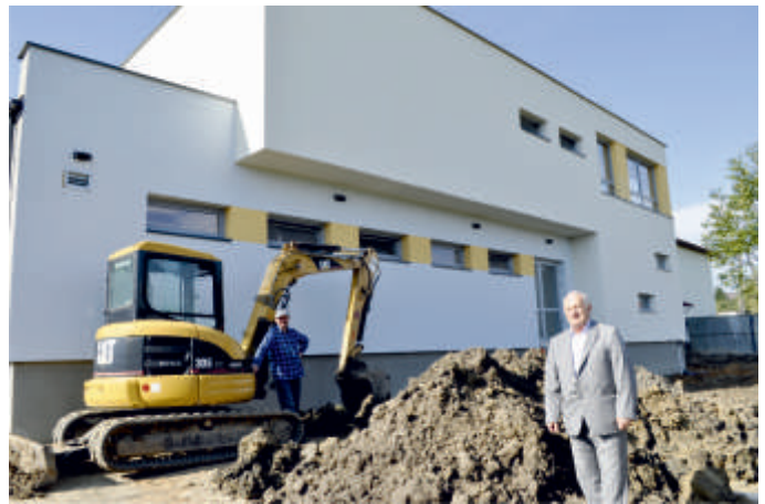
Wójt gminy Bogoria W. Brudek dogląda prac na budowie nowego skrzydła szkoły podstawowej w Jurkowicach, 2018 r.
